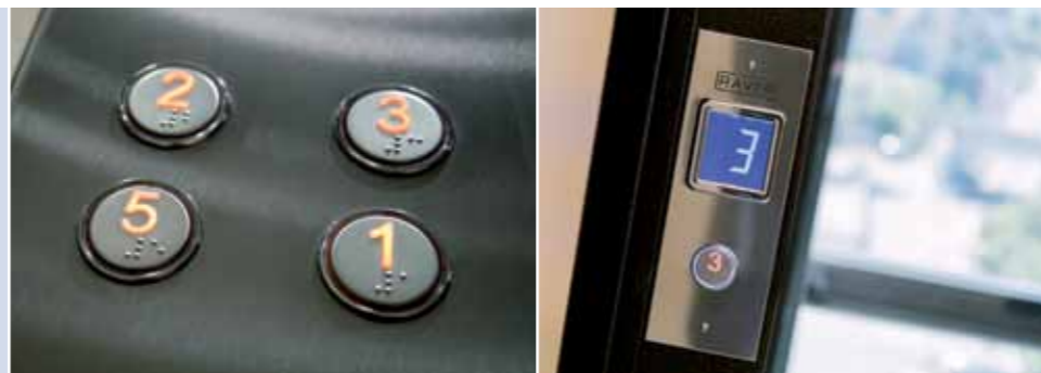
Pulsanti di cabina
